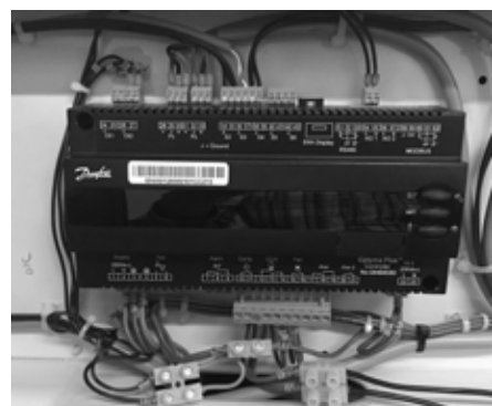
Bilde 4: Midlertidig kabling
