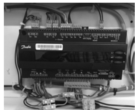
Bild 4: Vorläufige Verdrahtung für Notbetrieb
